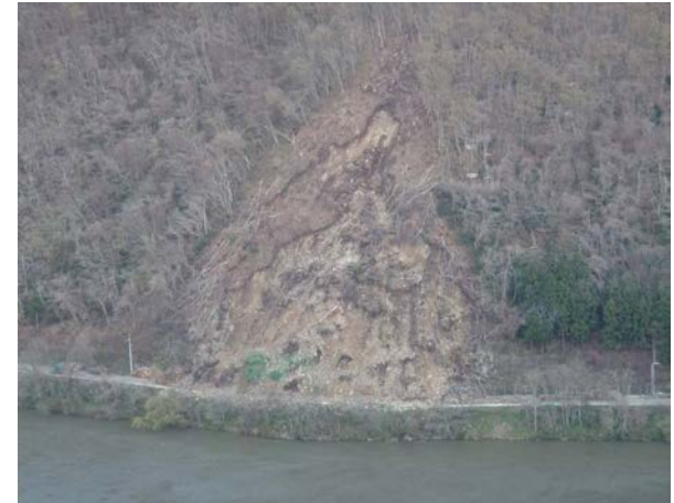
道路斜面の崩落 （東日本大震災での被災）
