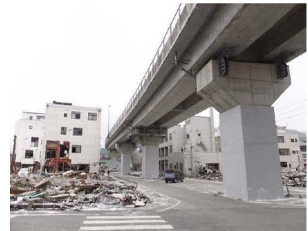
橋脚の耐震補強 （東日本大震災でも地震動による損傷無し）
